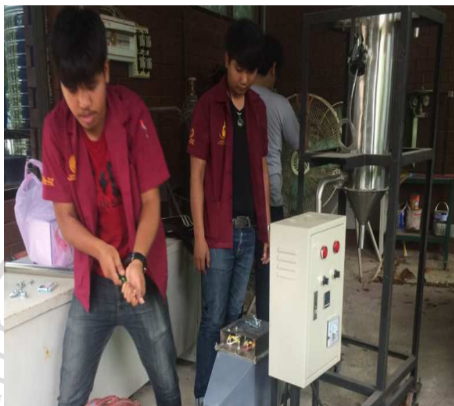
ภาพภาคผนวกที่ ก.5 การต่อตู้ควบคุมชุดฮีตเตอร์เครื่องอบแห้งพ่นฝอย
