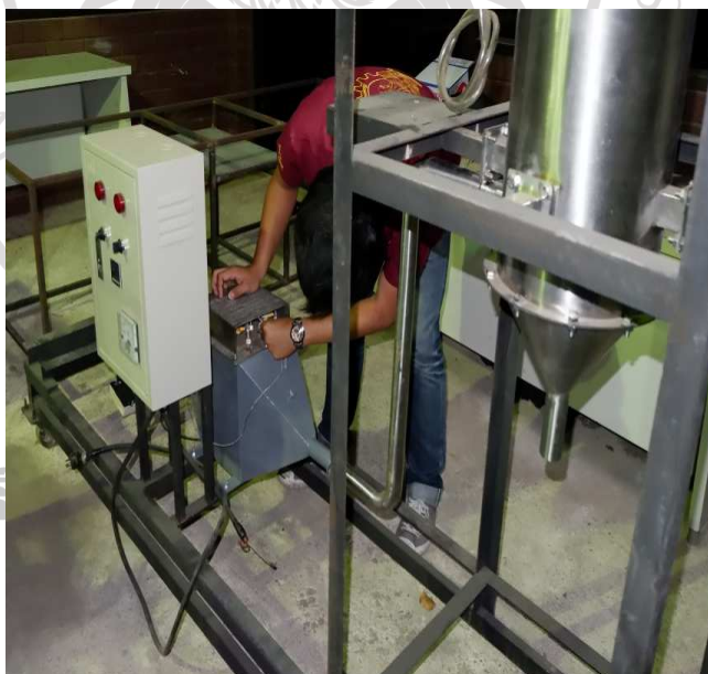
ภาพภาคผนวกที่ ก.4 การต่อสายไฟฟ้าชุดฮีตเตอร์เครื่องอบแห้งพ่นฝอย
