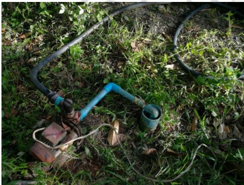
ภาพที่ 3.1 ปั๊มสูบน้ำบาดาล
