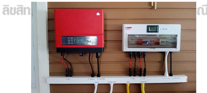
ภาพที่ 4.3 ชุดควบคุมระบบผลิตกระแสไฟฟ้าพลังงานแสงอาทิตย์
