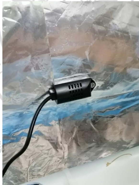
ภาพที่ ค1 แสดงการติดตั้งอุปกรณ์ควบคุมอุณหภูมิแบบอัตโนมัติ
