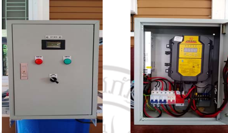
ภาพที่ 4.4 กล่องควบคุมระบบสาธิตสูบน้ำบาดาลน้ำดื่มพลังงานแสงอาทิตย์
