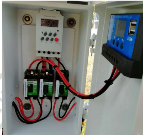
ภาพที่ ก3 การประกอบชุดควบคุมไฟฟ้าอัตโนมัติ
